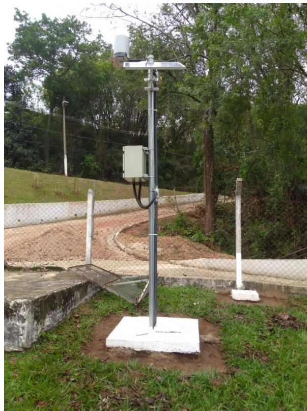
Estação Telemétrica Limpa (longe)
