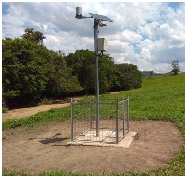
Estação Telemétrica Limpa (longe)
