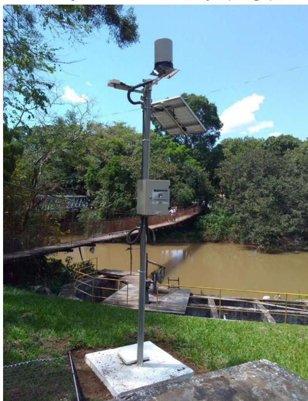
Estação Telemétrica Limpa (longe)
