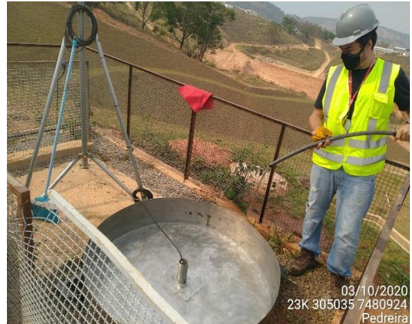
Foto 3 – Tanque do reservatório preenchido com água limpa. (Data: 03/10/2020).
