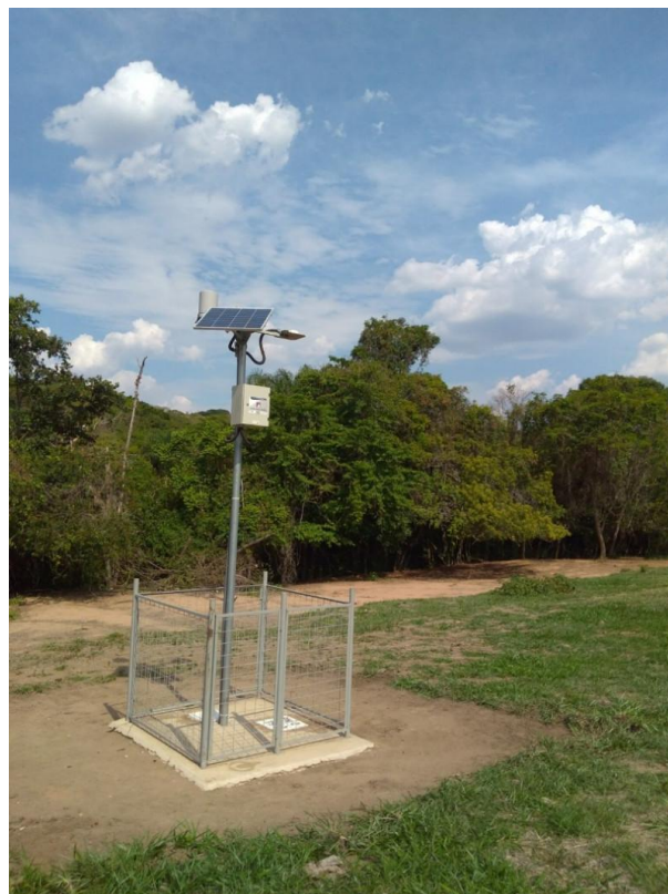
Estação Telemétrica Limpa (longe)
