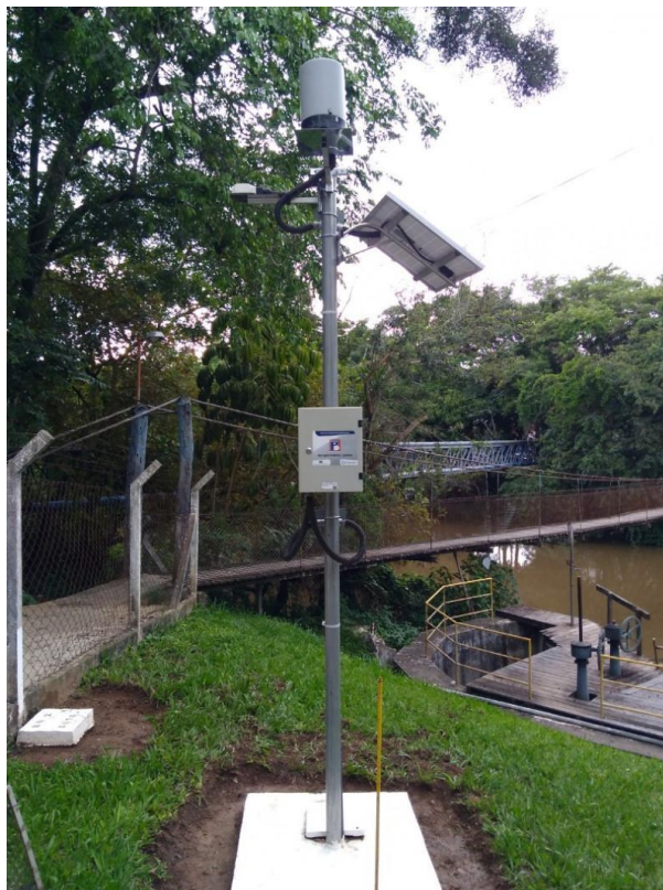
Estação Telemétrica Limpa (longe)
